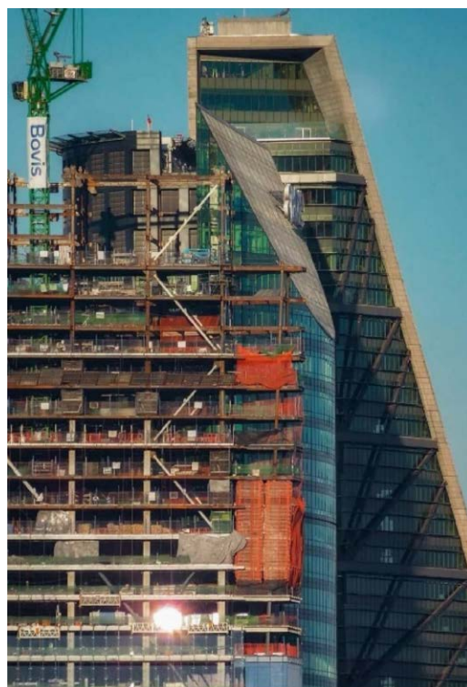
Figura 14. Tres de las torres en Paseo de la Reforma, Chapultepec. Torre Mayor en primer plano y por detrás sobresale la Torre Reforma.
